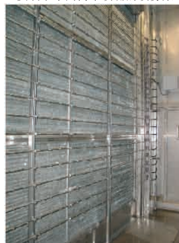
安装于车间内带喷嘴的喷雾架
