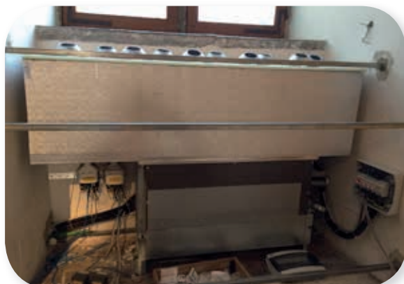
Detalle de instalación tipo en una sala del museo de: sistemas de humectación por ultrasonidos, deshumidificador y electrónica de gestión y regulación en instalación de acondicionamiento.
