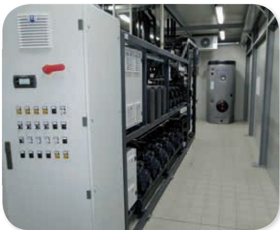
Central frigorífica tipo ENEX
