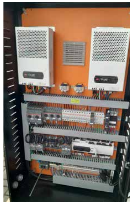
Fig. 1.b - Painel de comando da unidade DEMETRA integrando o controlador CAREL c.pCO e inversores Power+
