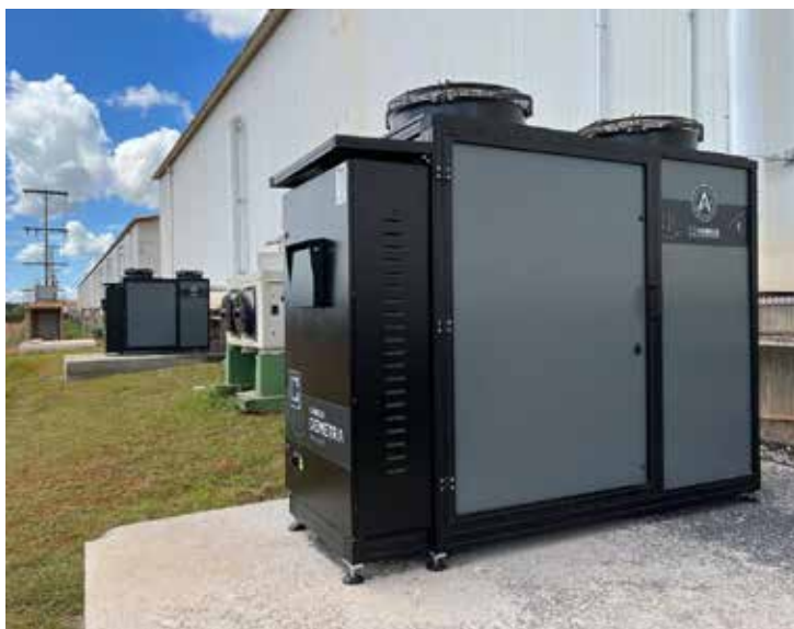
Fig. 1.c - Installazione Dois Marcos Sementes
