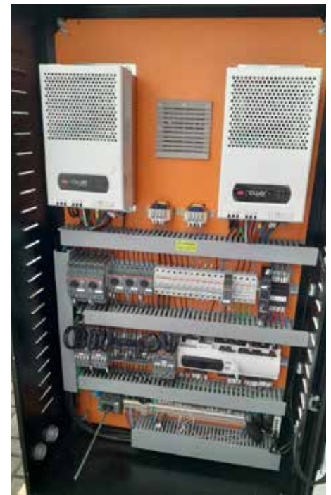
Fig. 1.b - Quadro elettrico dell'unità DEMETRA con integrazione del controllore CAREL c.pCO e degli inverter Power+
