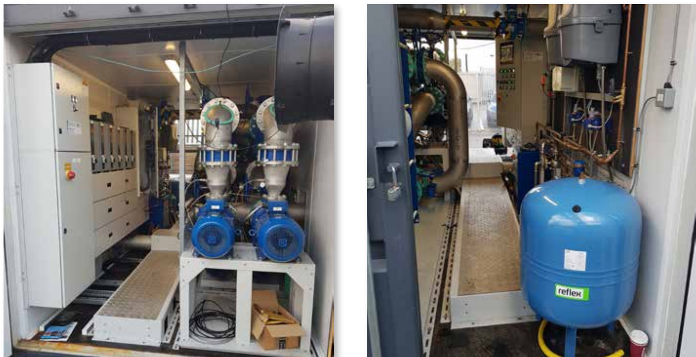
Fig. 1.c - Particolare interno centrale termica
