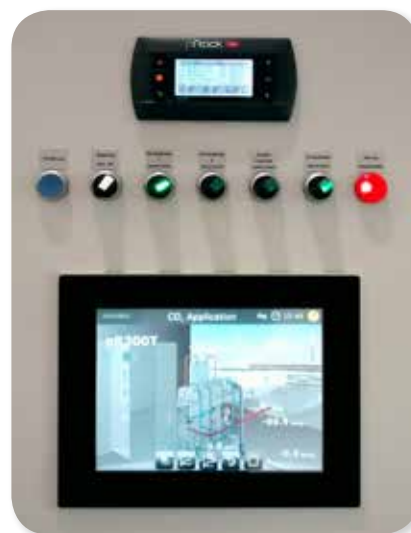
sinottico della centrale frigorifera disponibile sul quadro elettrico
