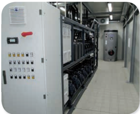
centrale frigorifique de type ENEX
